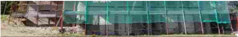
Pics. Tour nei cantieri presso la casa di Jonas Mastella: "Credo sia l'opera più bella"
